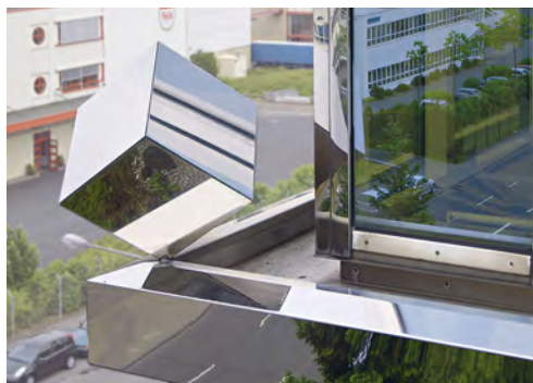
Kiiltohehketulla ruostumattomalla teräksellä verhoiltu julkisivu ennen ja jälkeen puhdistuksen. Huoltotoimenpiteet palauttavat heijastavalle pinnalle sen alkuperäisen hehkun. Valokuva: Christian Pohl GmbH, Köln (Saksa)
