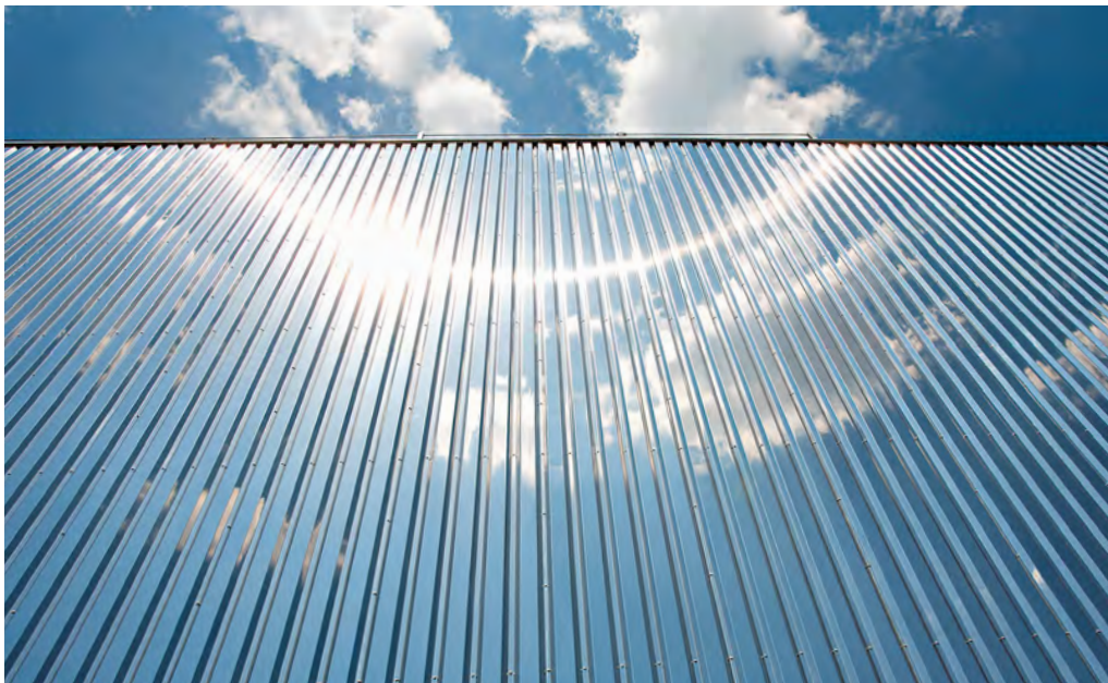
Hyvä itsepuhdistuvuus oli yksi syy, miksi teollisuusrakennuksen julkisivuun Puolan Siemianowice Ślqskiassa valittiin ruostumattoman teräslajiin 1.4526 kiiltohehketettu (2R) pinnan toimitustila. Valokuva: Aperam/ A. Zekri
